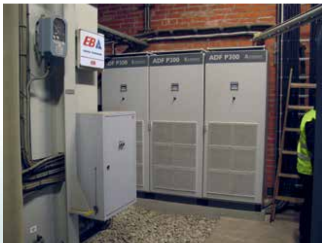
Активные динамические фильтры на трансформаторной подстанции
