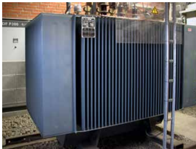
Согласующий трансформатор системы динамической компенсации
