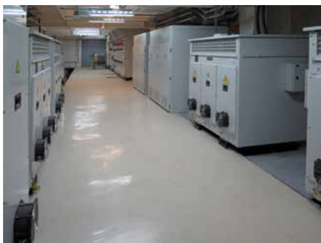
Групповой понижающий и индивидуальные повышающие трансформаторы высоковольтных электроприводов
