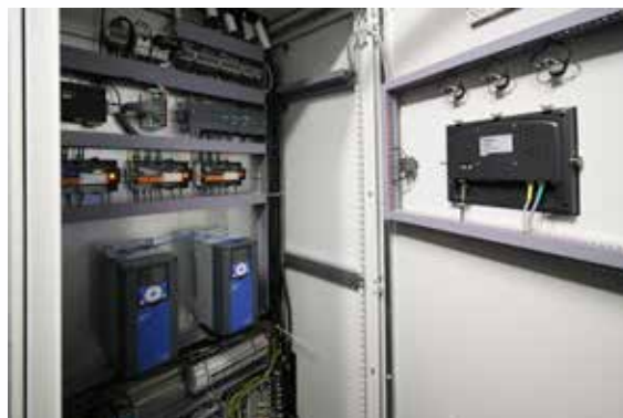
Система управления сетевым преобразователем и оборудованием отопления/вентиляции контейнера
