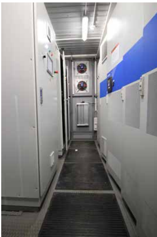
Сетевой преобразователь мощностью 800 кВА и вводно-распределительное устройство
