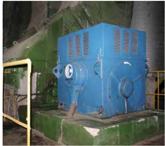
Привод дымососа (400 кВт, 6 кВ)
