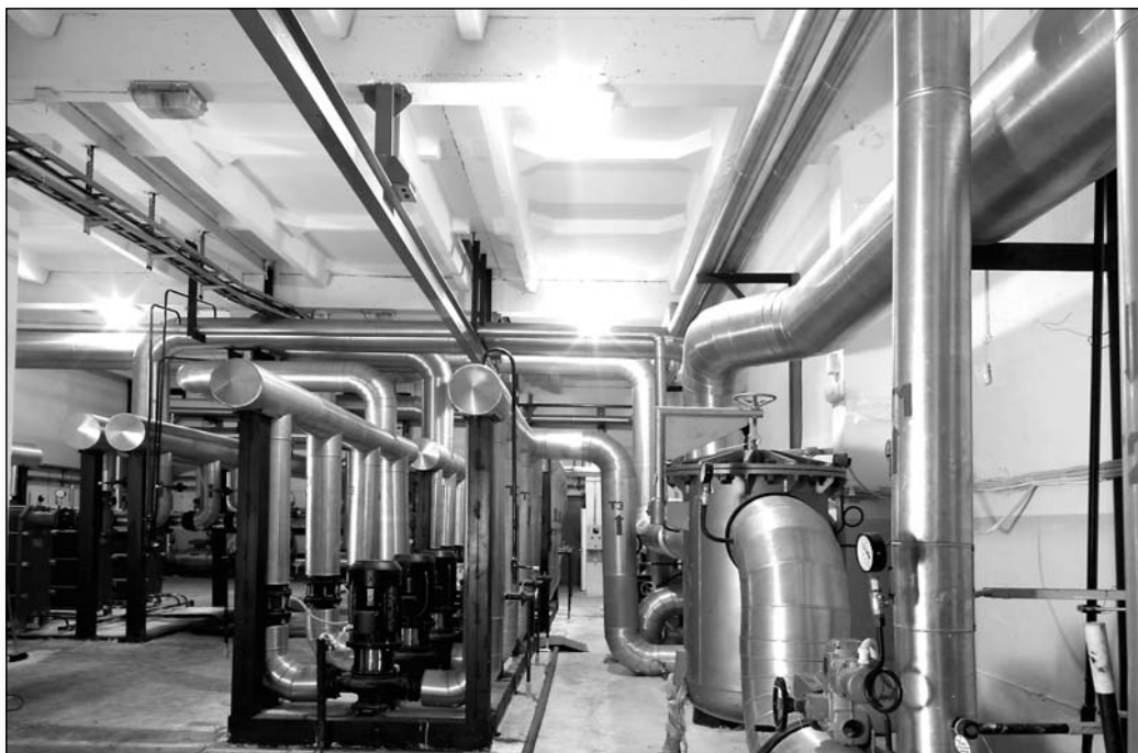
Рис. 2. Общий вид зала ЦТП квартала 17А, г. Колпино
