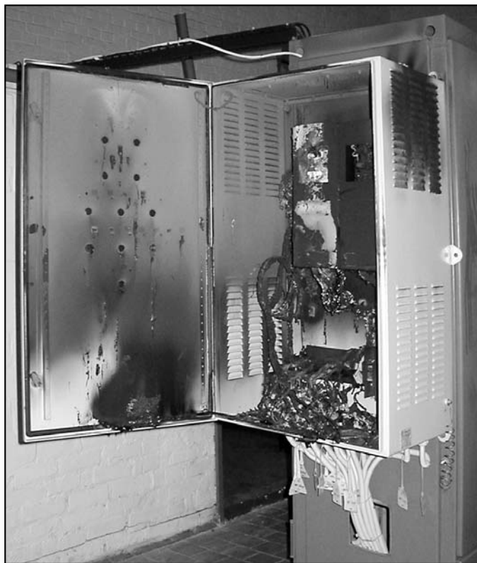
Фото 1. Внешний вид щита с преобразователями частоты после «выгорания» вводного автоматического выключателя
