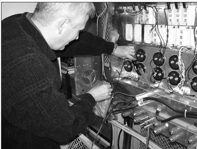
Рис. 13. Пример последствий аварии преобразователя частоты мощностью 630 кВт
