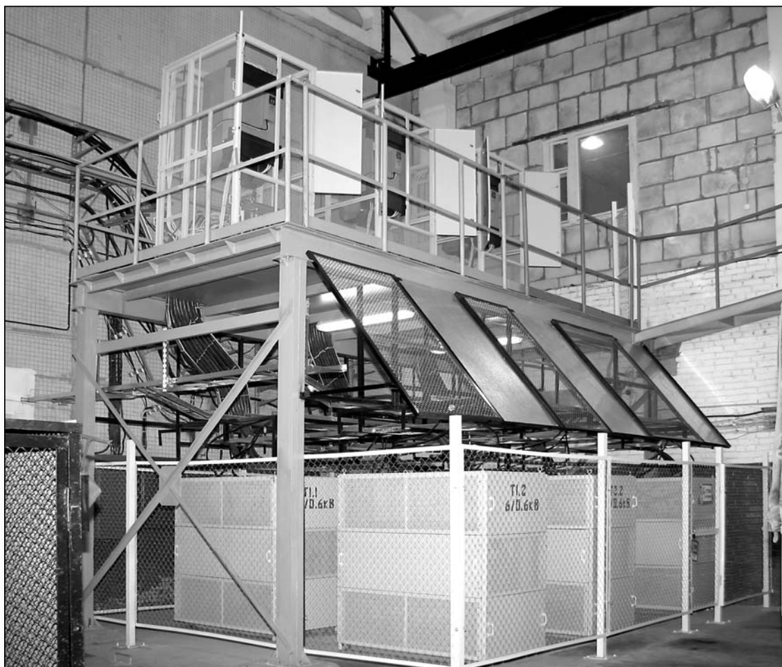
Рис. 9. Пример размещения силового оборудования высоковольтной СЧР в разных уровнях
